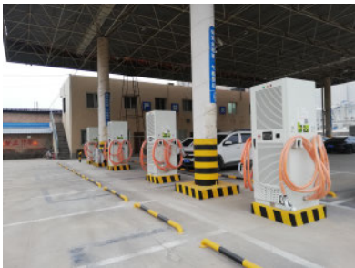
西安子午大道充电站 (公共充电场站)
