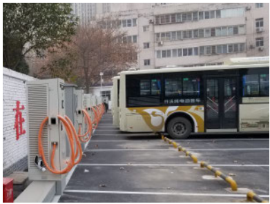
西安临潼三运司充电站
