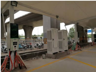
郑州二七区公交充电站 ( 公交充电场站 )
