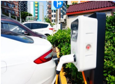
深圳新围村充电站 (工业园区)
