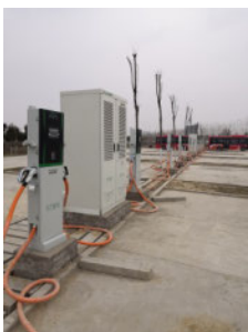
开封市兰考县充电站 (公共充电场站)
