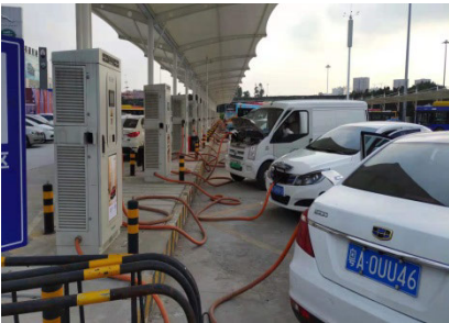
广州市天河区充电站 ( 公共充电场站 )
