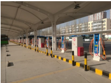
银川公交充电站 (公交车场站)
