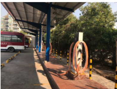
佛山充电站 (公交充电场站)
