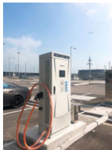
港澳第一台 国标充电桩
